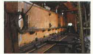
保全対象とする油圧プレス機
