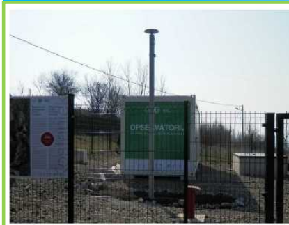
コスタニック地すべり観測施設
